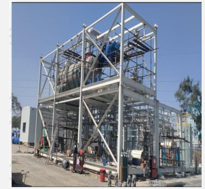
ZLD Plant : actual view
